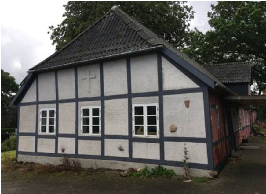
Renoveret nordgavl – foto fra syn på stedet den 3/9 2019
