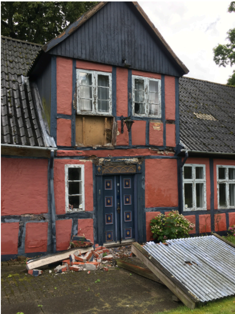
Gavlkvist på vestfacade - foto fra syn på stedet den 3/9 2019
