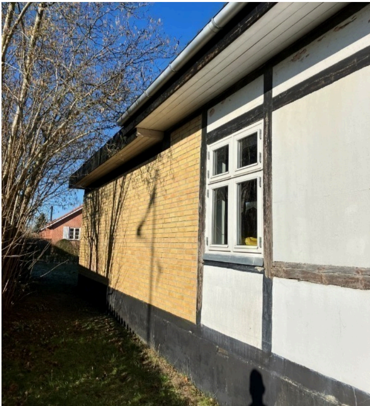
Herunder ses hvordan det nederste af villaens oprindelige bindingsværk flere steder er erstattet af beton – med råd i stolperne til følge.
