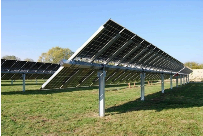
Figur 3: Eksempel på axial-tracker solpanel med en største højde på 4 m over terræn. Panelet vil i løbet af dagen vippe med solen, så panelet vender til den modsatte side. Fast opstillede solpaneler har omtrent de samme dimensioner, men opstilles i tættere rækker.
